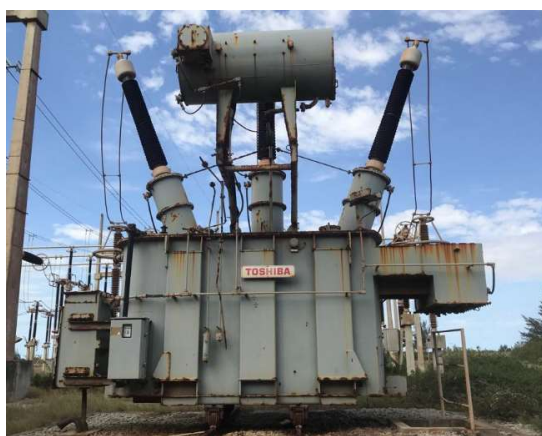
Transformador Regulador Toshiba 40MVA Trifásico
