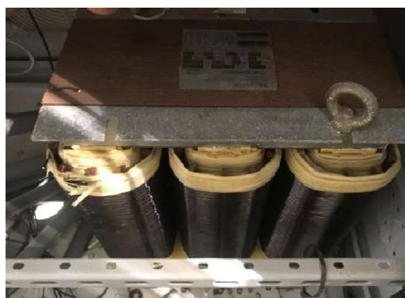
Transformador de tensão 220V/127V 19KVA Trifásico Blutrafos
