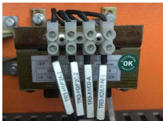
Transformador Bifásico 220V/120V
