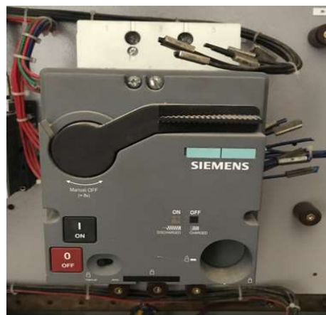
Motor de acionamento c/ disjuntor Siemens
