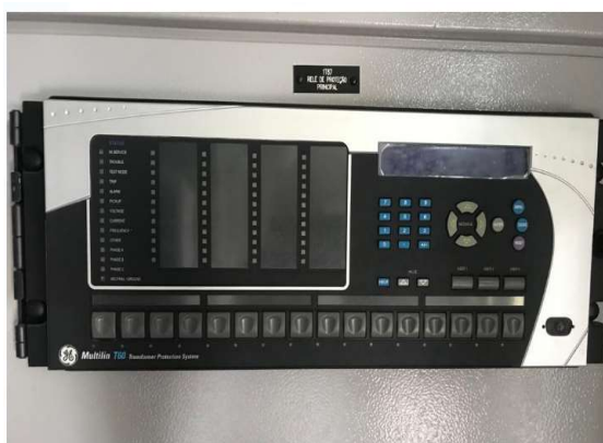
Relé de proteção GE Multilin T60
