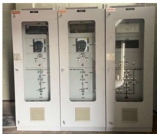
Quadro de distribuição
