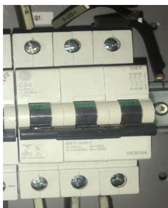
Disjuntor GE Trifásico
