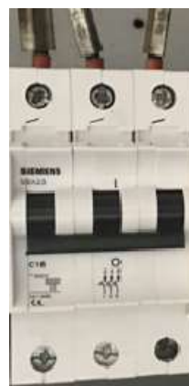
Disjuntor Siemens Trifásico
