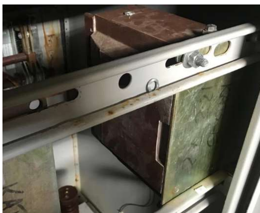
Transformador de Corrente Trifásico
