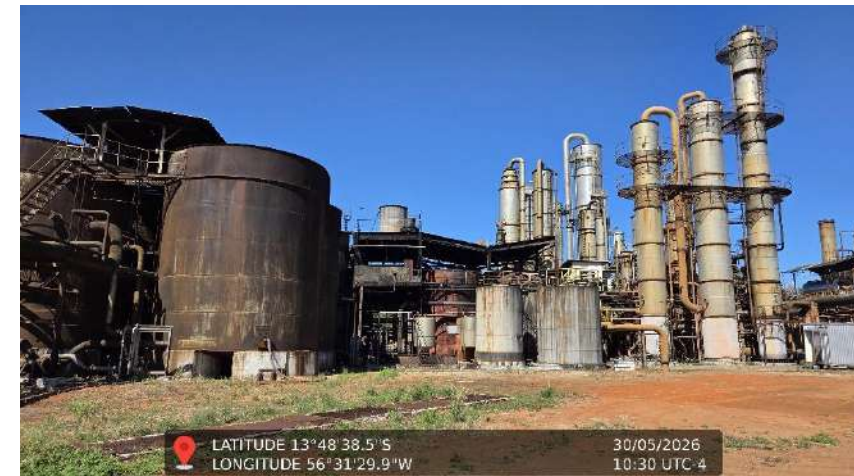
Figura 137 - Imagem da destilaria da usina
