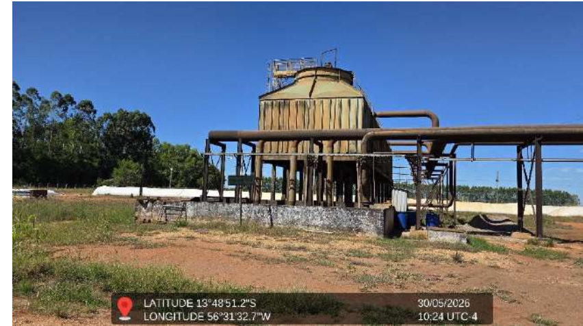
Figura 174 - Imagem da torre de resfriamento
