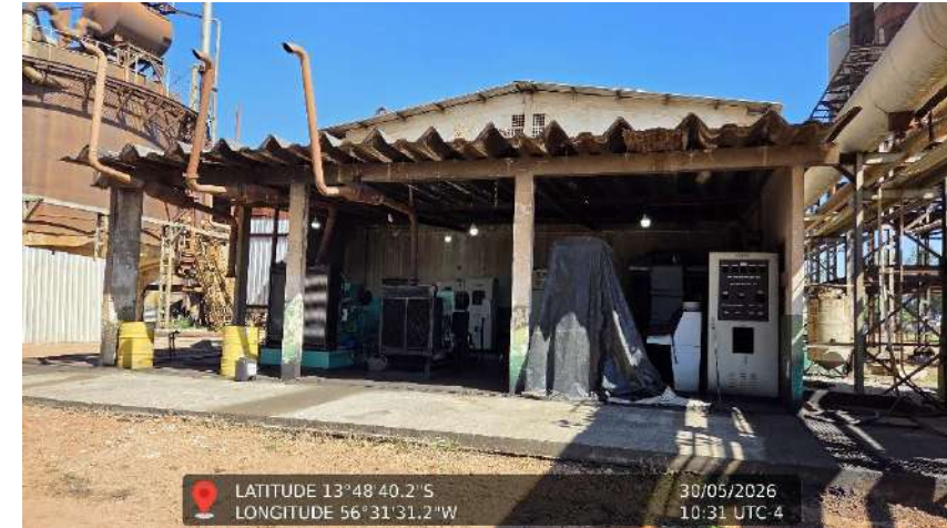
Figura 136 - Imagem do sistema de geradores de energia
