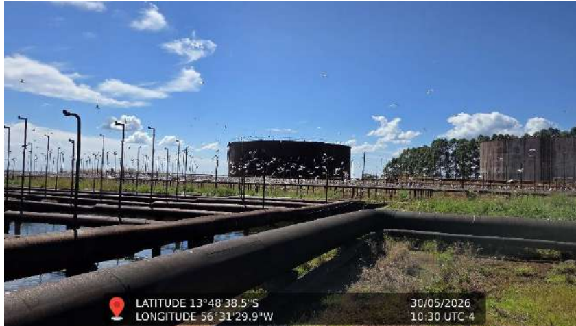
Figura 134 - Imagem do sistema de refrigeração desligado
