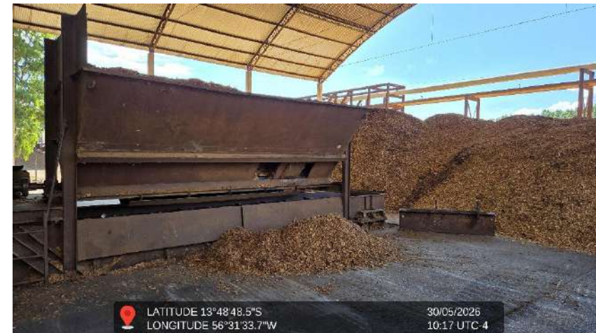
Figura 175 - Imagem da biomassa para alimentar a caldeira
