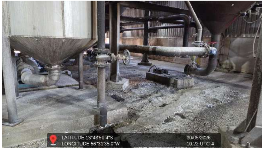
Figura 164 - Imagem das bombas elétricas em manutenção
